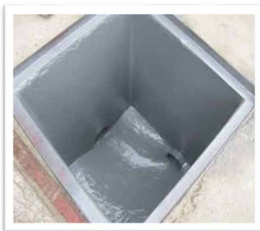
Figura 11: TANQUE DE ALMACENAMIENTO
