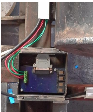
Figura III-75. Cableado Tarjeta Electrónica 4 Fuente.- Los Autores
