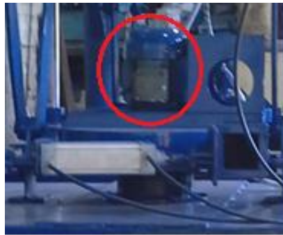
Figura III-10. Motor Blower Fuente.- Los Autores
