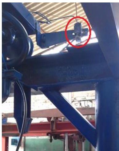
Figura III-78. Final de Carrera Izquierda Fuente.- Los Autores
