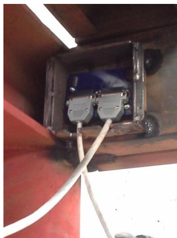
Figura III-73. Cableado Tarjeta Electrónica 2 Fuente.- Los Autores
