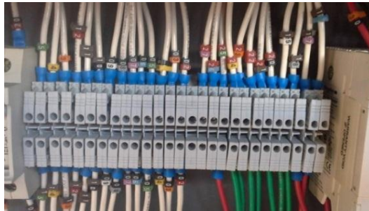
Figura III-69. Señalización del Tablero Fuente.- Los Autores
