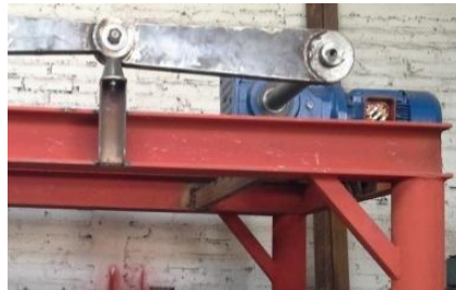
Figura IV-96. Motor de la Transmisión Fuente.- Los Autores
