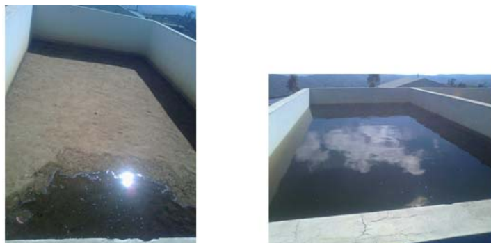
Figura 2-2: Tanques de Filtración
