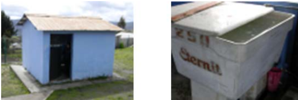
Figura 2-3: Caseta y tanque de cloración
