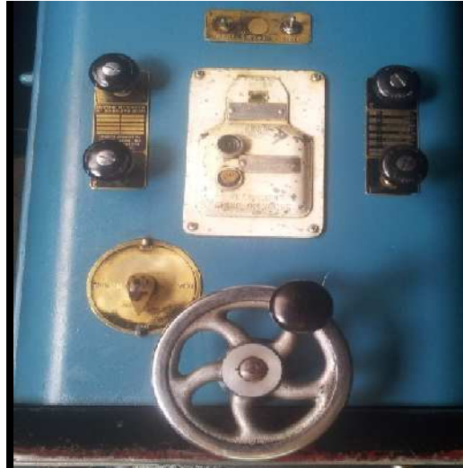
Figura 106. Encendido del banco
