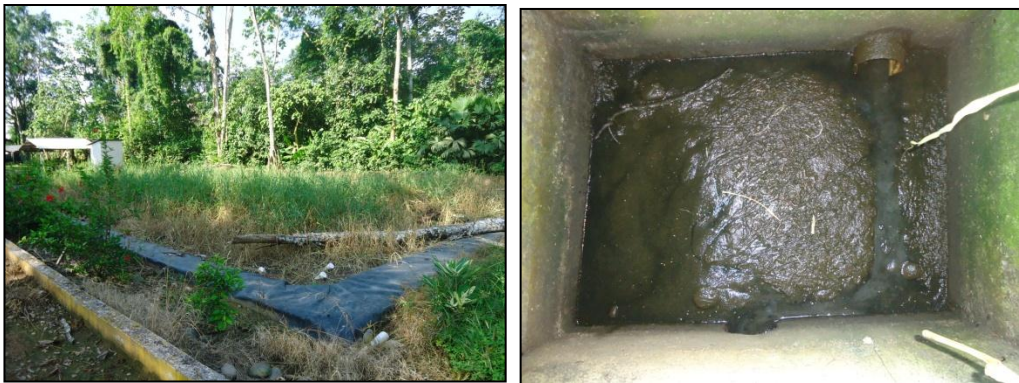
(e) Humedal 1 sin funcionamiento por el taponamiento de tubería.
