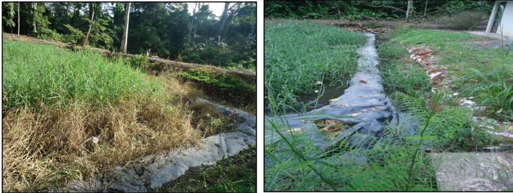
(g) Exceso de tierra en las cuentas perimetrales
