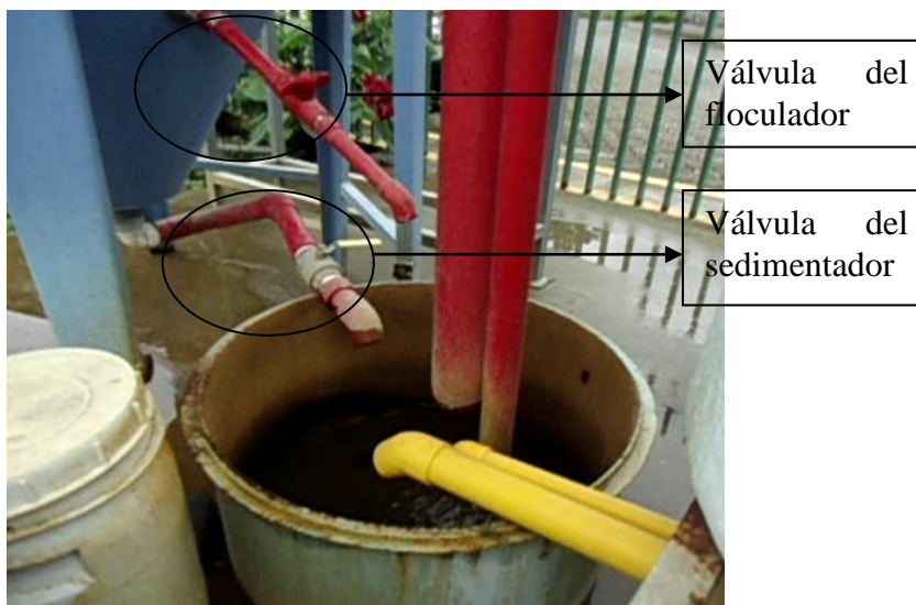
FOTOGRAFÍA 14. Válvulas de descarga floculador/sedimentador
