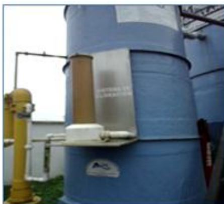
FOTOGRAFÍA 4. Sistema de dosificación de cloro en tabletas
