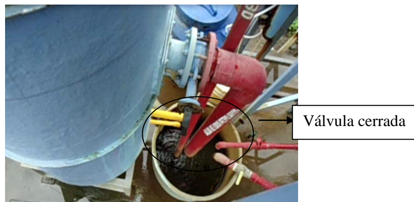
FOTOGRAFÍA 10. Válvula de lodos de retrolavado del filtro
