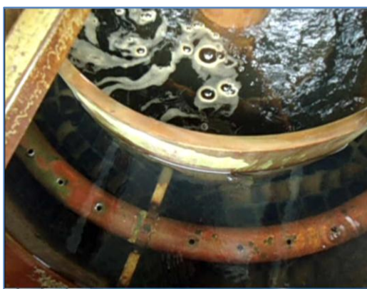
FOTOGRAFÍA 2. Tanque floculador / sedimentador
