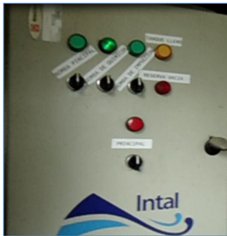
FOTOGRAFÍA 8. Tablero de control
