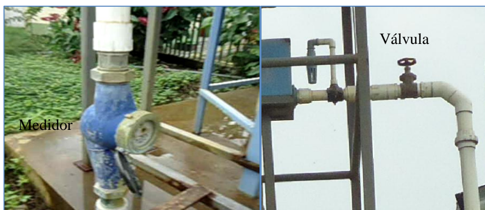
FOTOGRAFÍA 12. Medidor y válvula para regular caudal
