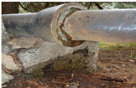
Figura 27. Modo de fallo evidente por fuga de una tubería
