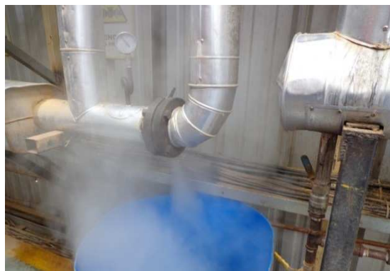
Figura 26. Efecto de un modo de fallo por una fuga de la tubería de vapor
