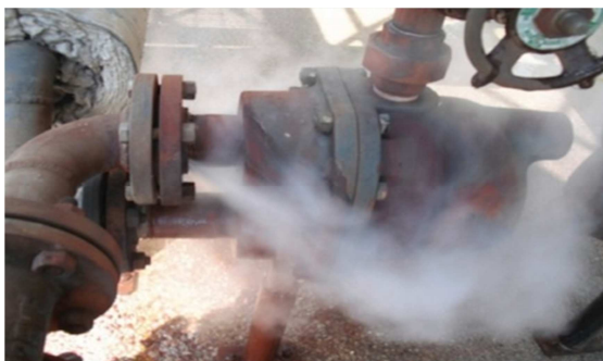
Figura 30. Falla potencial por fisuras de la brida en la válvula
