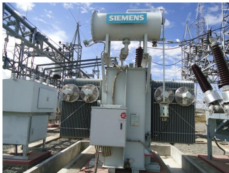
Figura 9. Transformador de potencia
