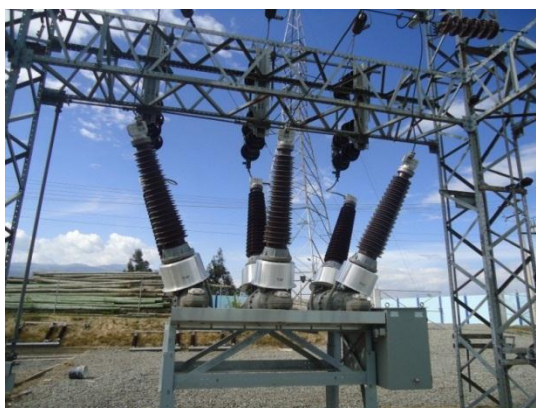
Figura 13. Disyuntor a 69 Kv
