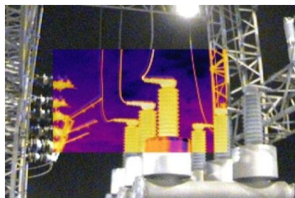
Figura 31. Imagen térmica mezclada IR y real
