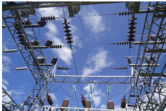
Figura 14. Barras colectoras a 69 Kv
