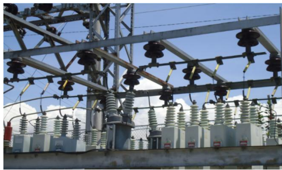
Figura 16. Banco de capacitores
