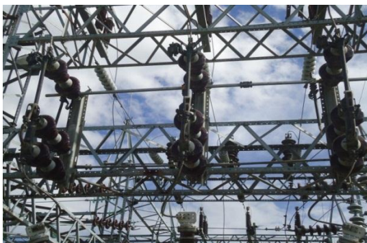
Figura 12. Seccionadores barras a 69 Kv
