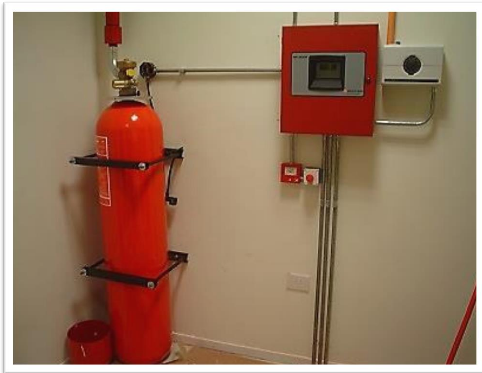
Figura 30. Gabinete de seguridad para la extinción de incendios
