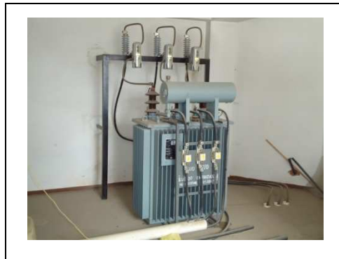
Figura 16. Transformador de 160 kva
