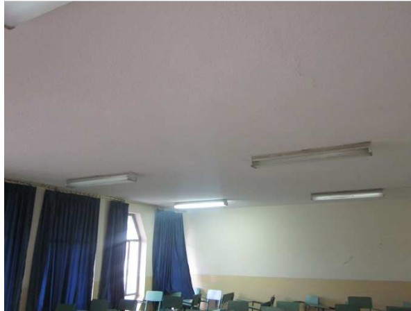
Figura 64. Luminarias defectuosas y quemadas
