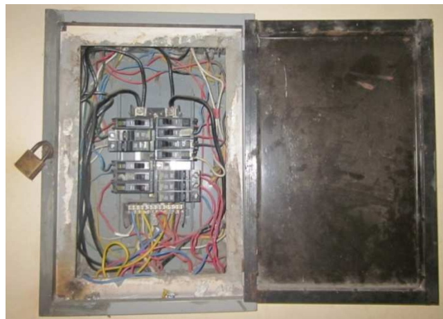
Figura 63. Caja térmica del edificio de los CAB de Mecánica
