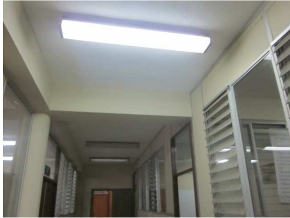
Figura 62. Circuitos mal distribuidos en el Edificio de Mecánica
