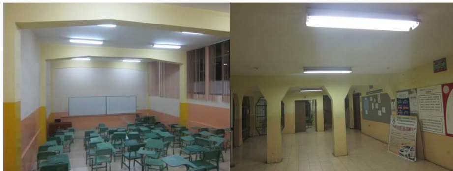
Figura 18. Iluminación típica en aulas y pasillos
