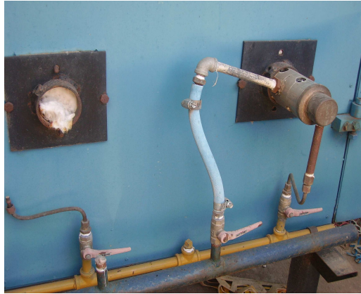
Figura 14 Ductos de aire y combustible que van al quemador.
