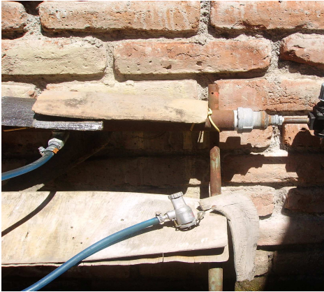
Figura 13 Válvula de entrada del combustible.
