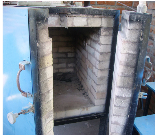
Figura 10 Vista interior del horno.
