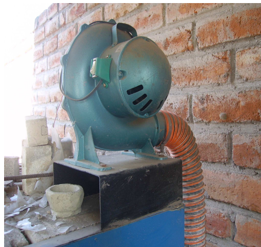
Figura 19 Ventilador ubicado en la parte superior.
