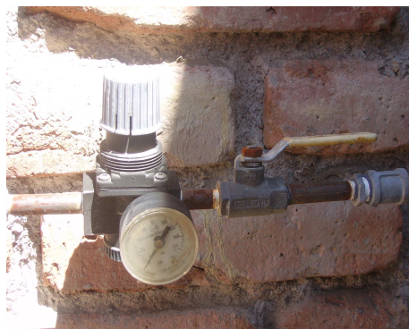
Figura 15 Indicador y controlador de presión
