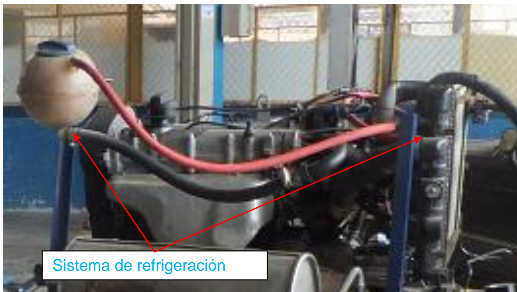
Figura 88. Sistema de refrigeración
