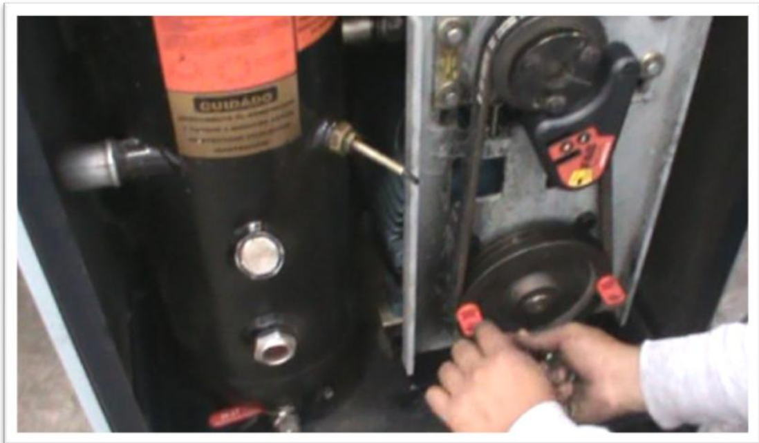
Figura 100. Marcas de referencia en el compresor industrial
