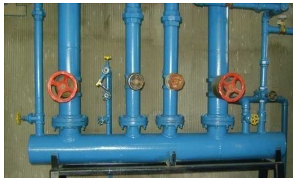
Figura24. Distribuidor de agua
