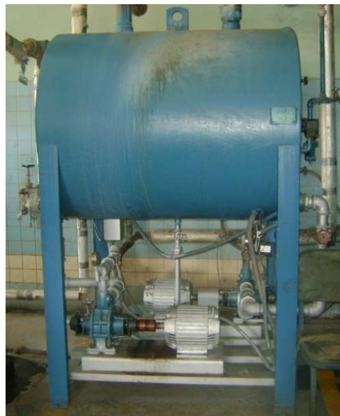
Figura 13. Tanque recolector de condensado
