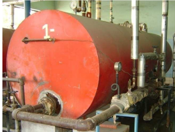
Figura 9. Acumulador de vapor
