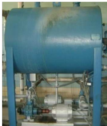
Figura18. Tanque recolector de condensado
