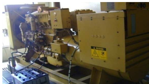
Figura 26. Motor generador caterpillar
