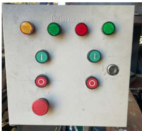
Ilustración 0-2: Panel de Control
