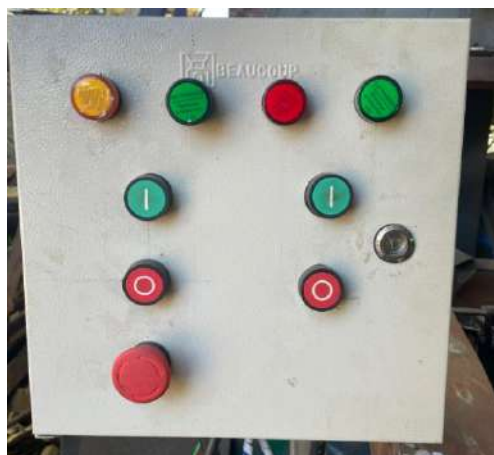
Ilustración 3-69: Panel de Control
