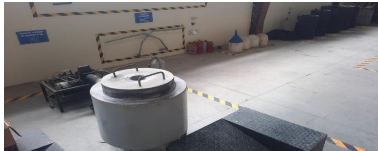
Ilustración 4-2: Disposición del horno a diésel en el laboratorio de mecánica de la facultad.
