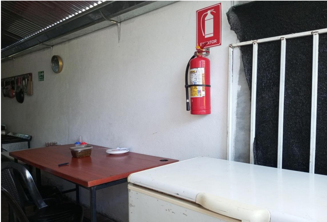
ANEXO M: EXTINTOR CONTRA INCENDIOS RESTAURANTE “MUMO LOUNGE”
