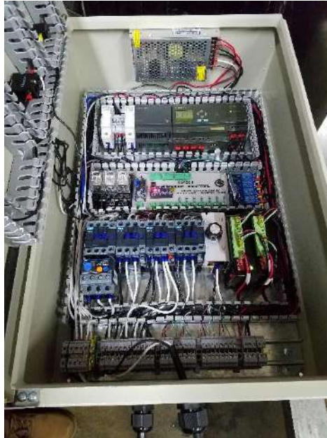
Ilustración 3-65: Vista interna del gabinete eléctrico. Realizado por: Lasluisa D., Lozada C.,2023
