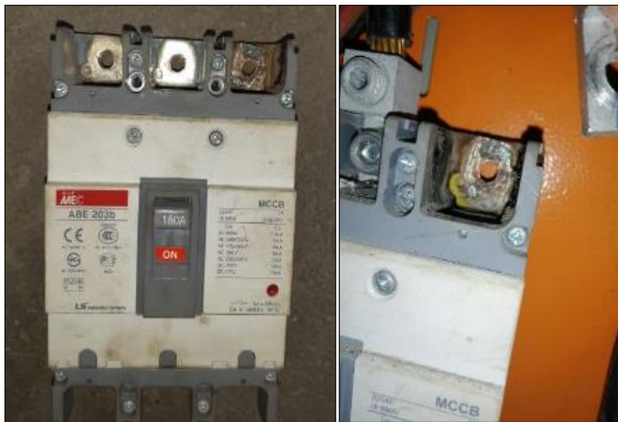
Figura 7-2: Bornes sobrecalentados en el Interruptor termomagnético principal Realizado por: Tamami Carlos, 2020
