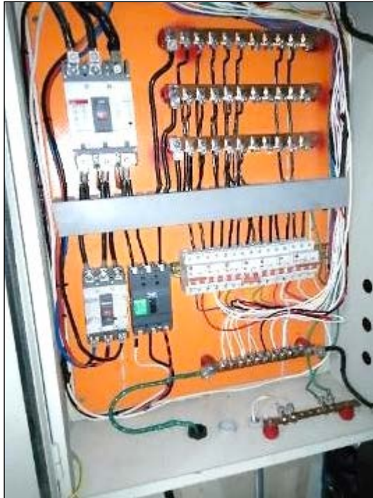
Figura 13-2: Tablero eléctrico principal después del mantenimiento Realizado por: Tamami Carlos, 2020
