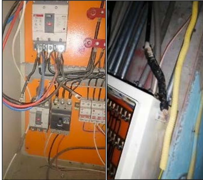
Figura 6-2: Cables eléctricos sobrecalentados y sueltos Realizado por: Tamami Carlos, 2020
