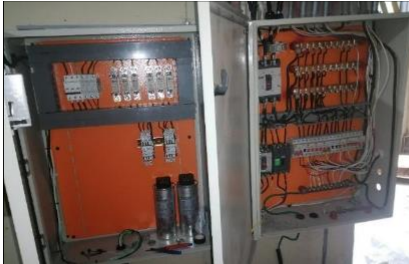
Figura 38-2: Gabinete del banco de condensadores junto al tablero principal Realizado por: Tamami Carlos, 2020
