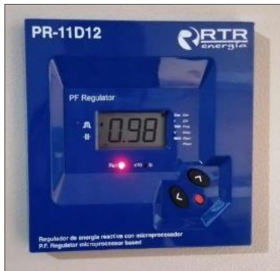
Figura 1-3: Controlador de factor de potencia en funcionamiento Realizado por: Tamami Carlos, 2020
