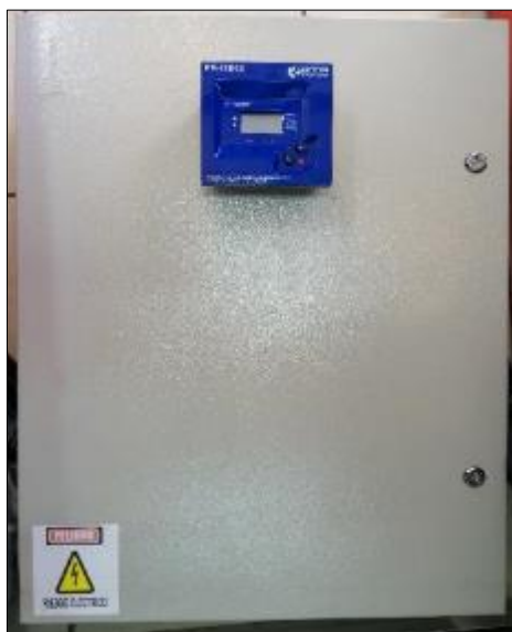
Figura 37-2: Gabinete para el banco de condensadores Realizado por: Tamami Carlos, 2020
