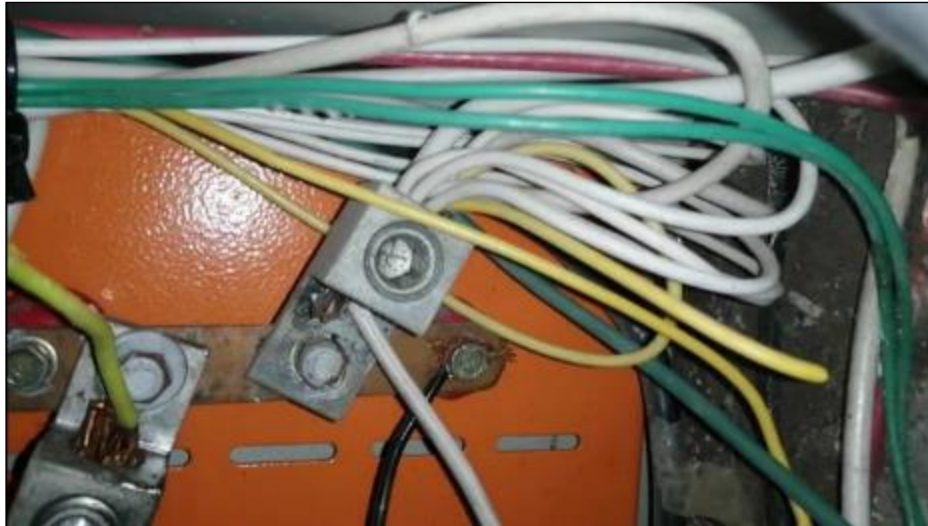
Figura 8-2: Cables eléctricos del neutro sin barras, colocado en una sola bornera Realizado por: Tamami Carlos, 2020
