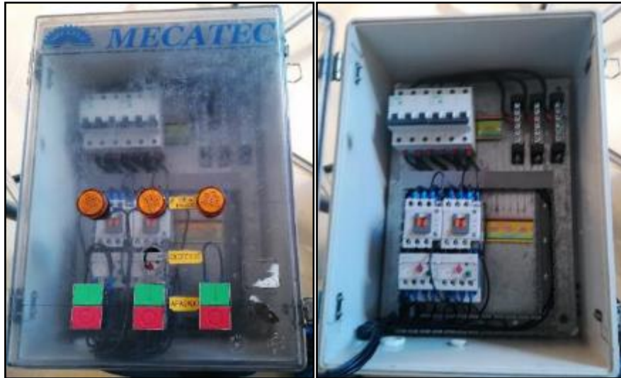
Figura 16-2: Nuevo tablero para descremadora de leche Realizado por: Tamami Carlos, 2020
