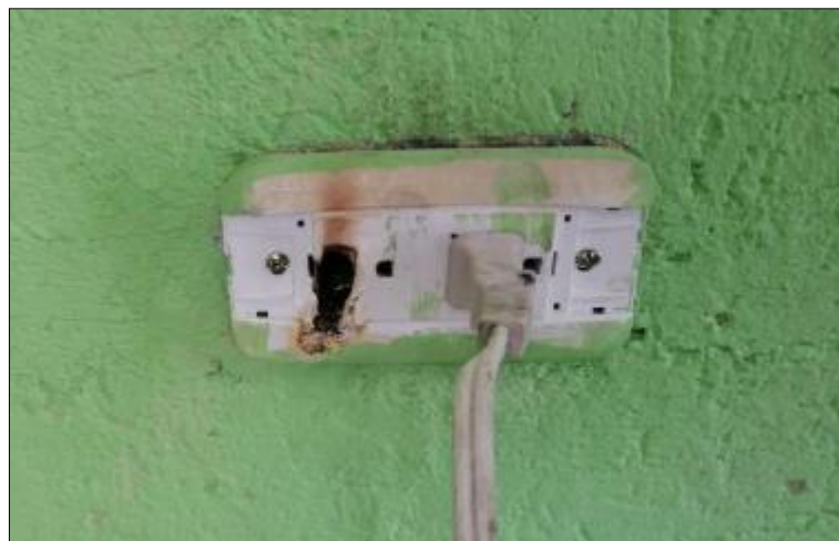
Figura 15-2: Toma corriente quemado Realizado por: Tamami Carlos, 2020
