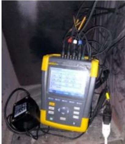
Figura 2-2: FLUKE 435 instalado en la fábrica Realizado por: Tamami Carlos, 2020
