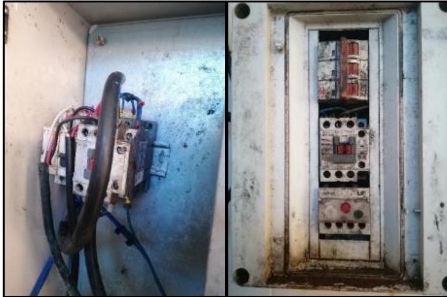
Figura 14-2: Tablero para descremadora de leche en mal estado Realizado por: Tamami Carlos, 2020
