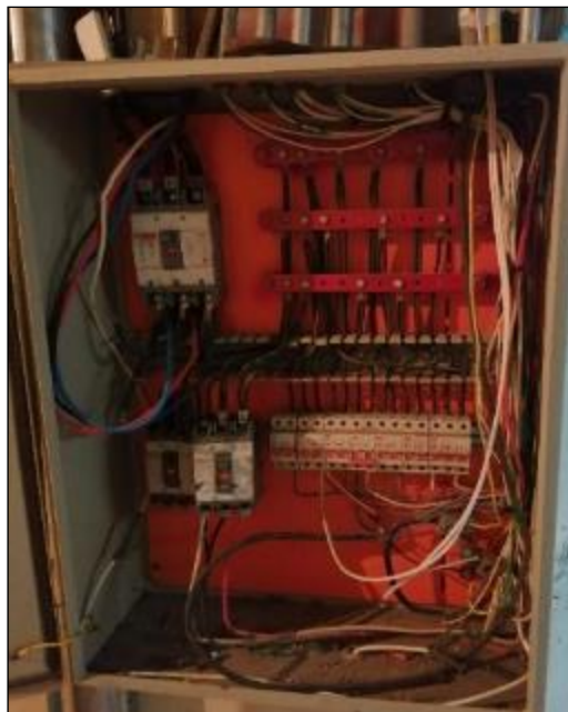
Figura 5-2: Tablero principal de la fábrica de quesos Realizado por: Tamami Carlos, 2020
