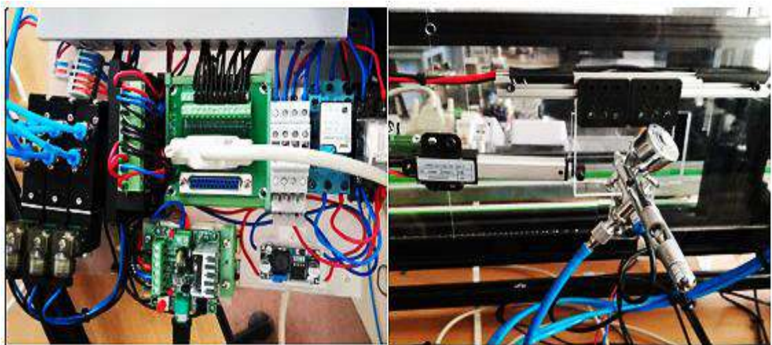
Ilustración 3-36: Elementos hardware utilizados en el montaje de la etapa de Pintado
