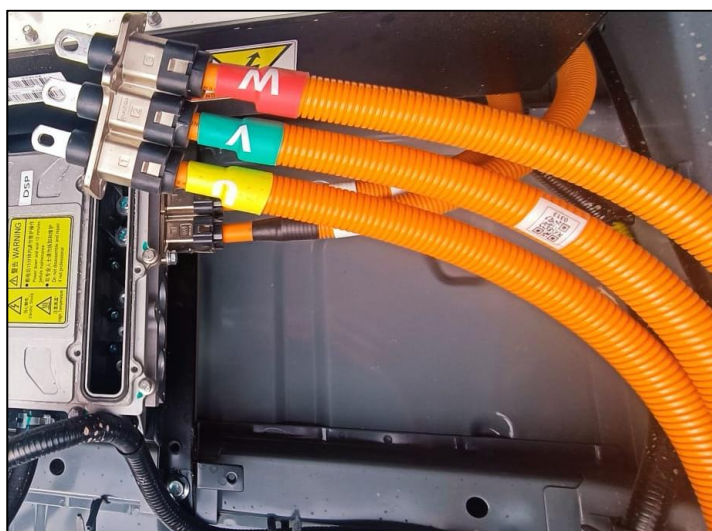
Ilustración 3-19: Cables de fase U-V-W (Inversor - Motor)
