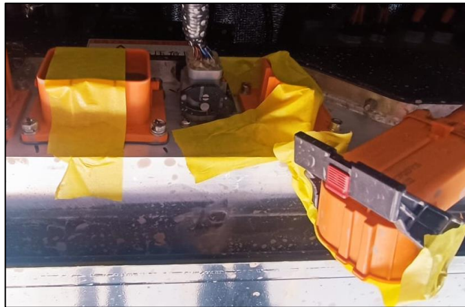
Ilustración 3-14: Protección de terminales de conexión
