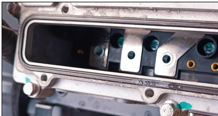
Ilustración 3-18: Terminales de fase U-V-W (Inversor)
