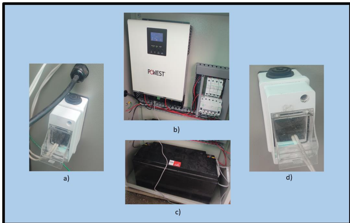
Figura 5-4: a) Entrada AC, b)Inversor hibrido, c) centro de carga, d) Salida AC.
