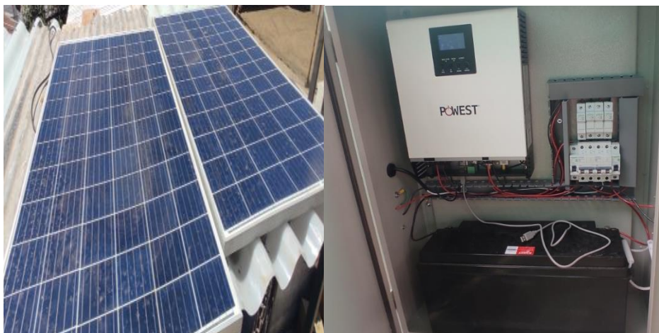
Figura 4-4: Ubicación de paneles solares fijos. Realizado por: Totoy E;2022
