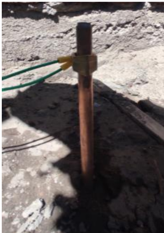
Figura 7-4: Varilla para puesta a tierra.
