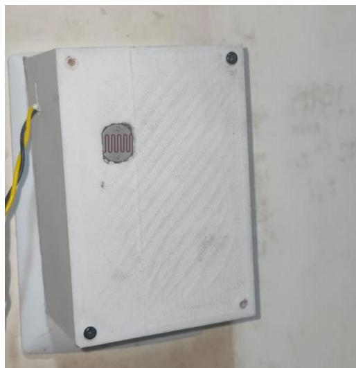
Figura30-2: Instalación del interruptor IoT en la sala del hogar.
