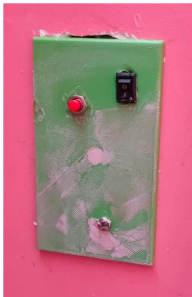
Figura24-2: Instalación del interruptor IoT.
