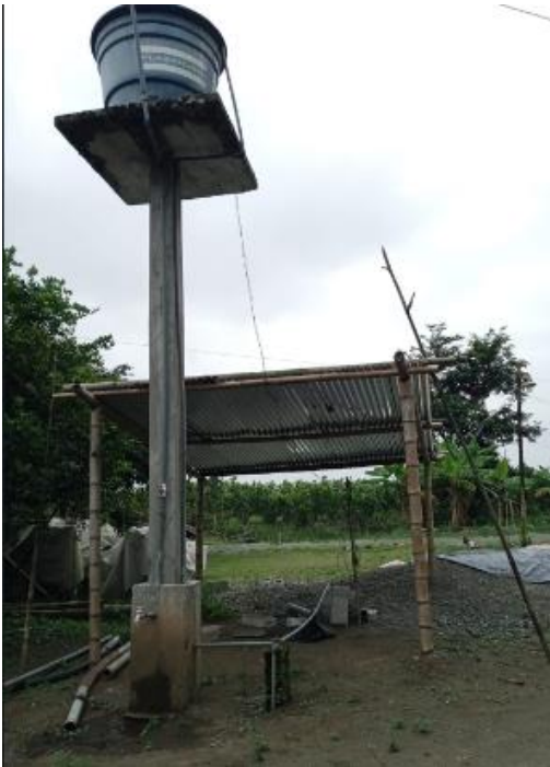
a) Tanque colector de agua subterránea
