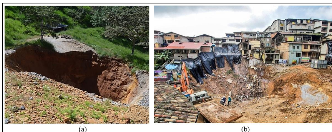
Figura 4-3. Socavones en la ciudad Zaruma: (a) Formación de socavón a las afueras de la ciudad; (b) Destrucción de viviendas por socavón generado en el centro de la ciudad
