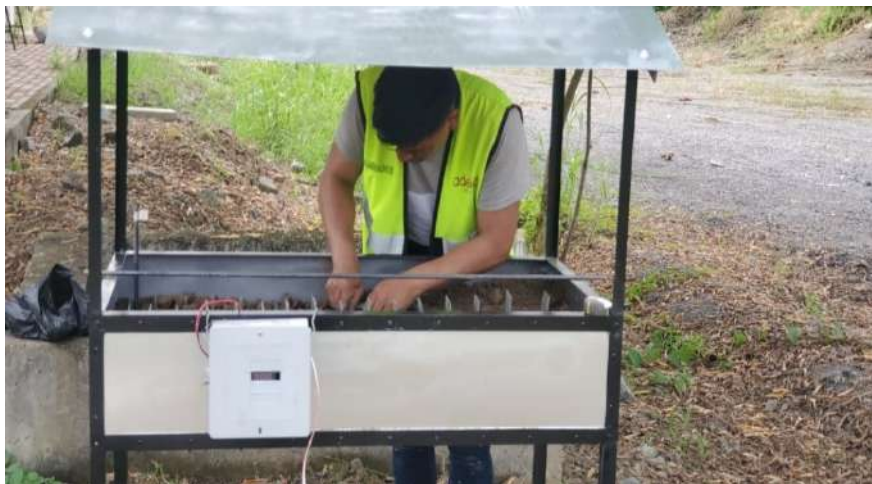
Ilustración 3-31: Instalación de voltaje para la protección catódica Realizado por: (Guallo, H; Guamán, J, 2023)
