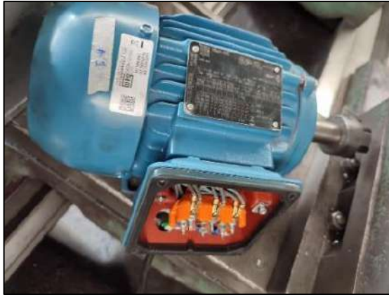
Ilustración 3-13: Motor trifásico de 1Hp
