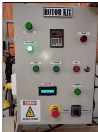
Ilustración 3-76: Tablero de control
