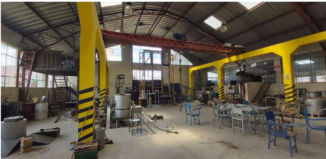
Ilustración 3-6: Piso en mal estado
