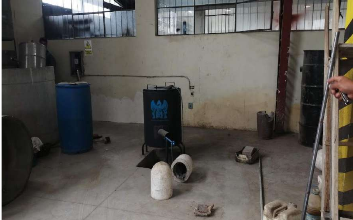
Ilustración 3-7: Paredes en mal estado
