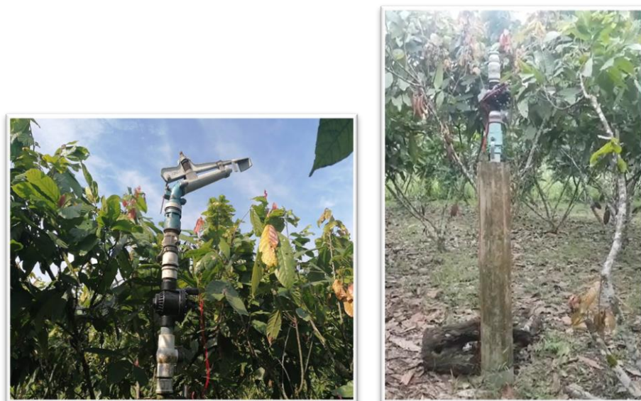
Figura 5-3: Electroválvulas instaladas en los postes de riego.
