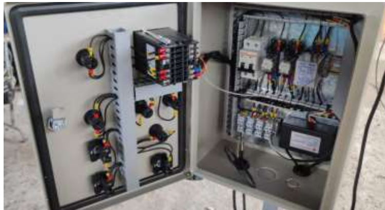
Ilustración 3-44: Tablero de control.
