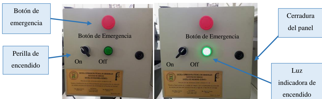
Ilustración 4-4: Parte exterior del panel de control de la celda de flotación. Fuente: Godoy, L., Valle, A., 2022.
