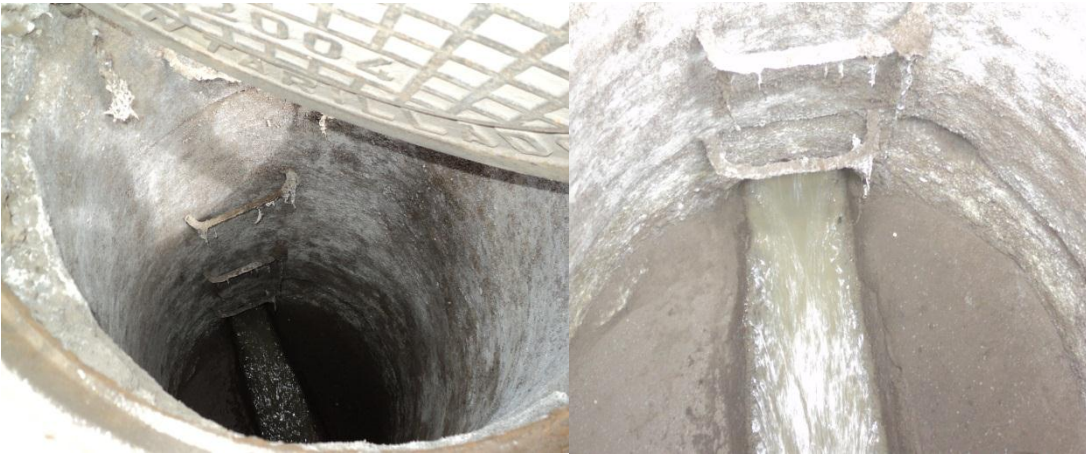
Punto de descarga de aguas residuales
