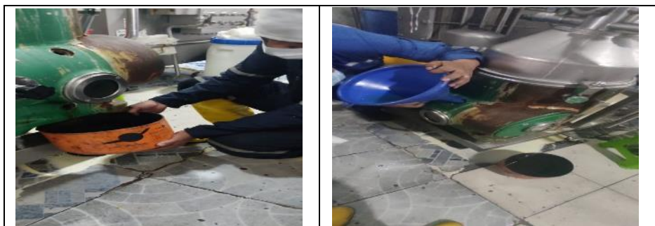
Ilustración 3-20: Defectos de la pasteurizadora
