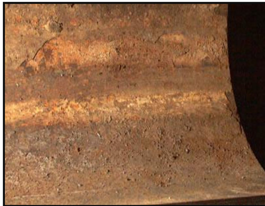
Figura 1.7. Fotografía de corrosión general o uniforme
