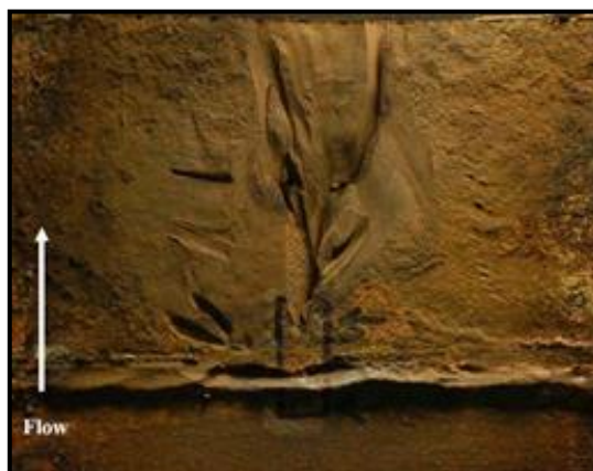
Figura 1.11 Erosión interna de una tubería
