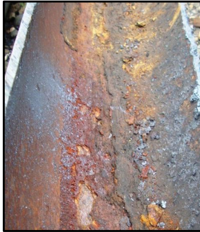
Fotografía 1 Pérdida de espesor a las 6:00 y alrededores
