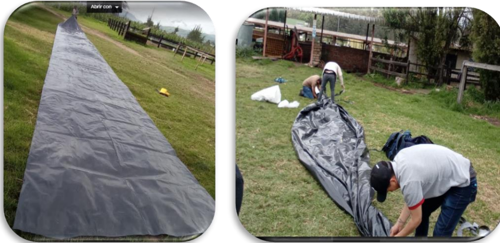
Ilustración 11-3: Templado del plástico reactor a la izquierda y anclaje de tubería a la derecha.
