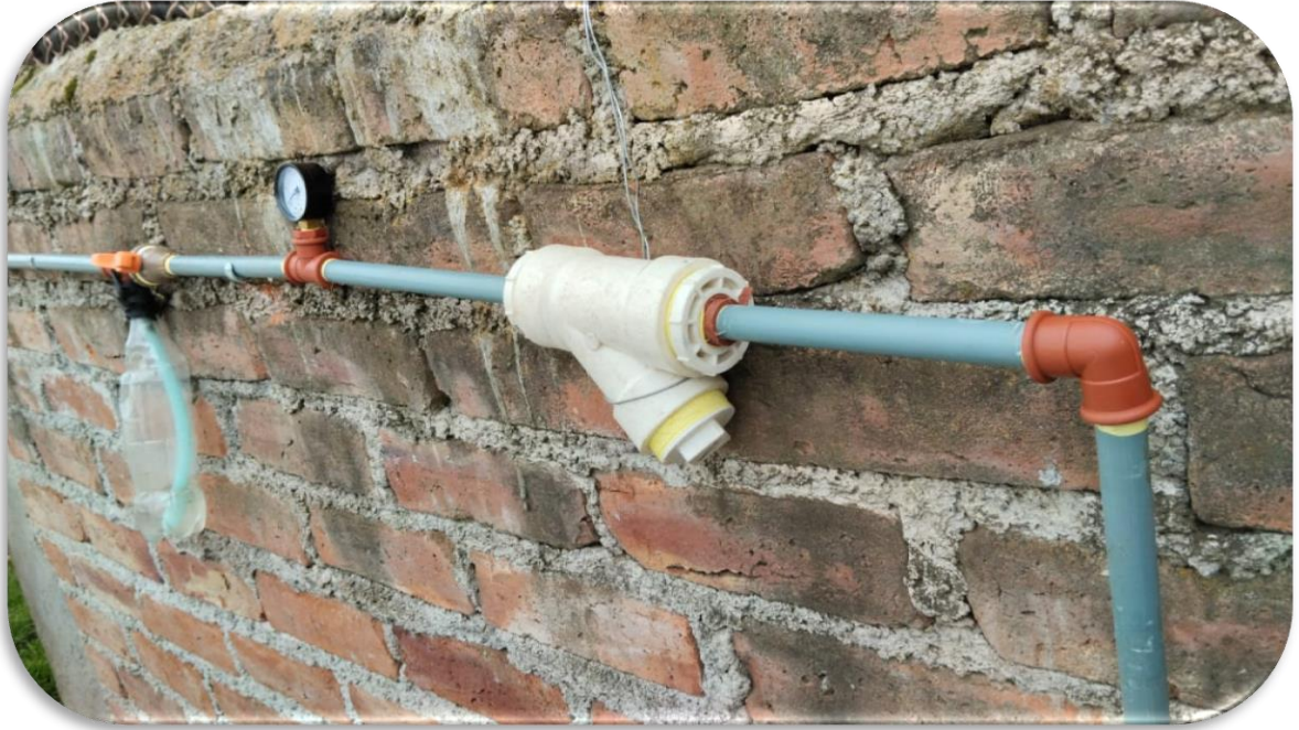
Ilustración 12-3: válvulas de seguridad.
