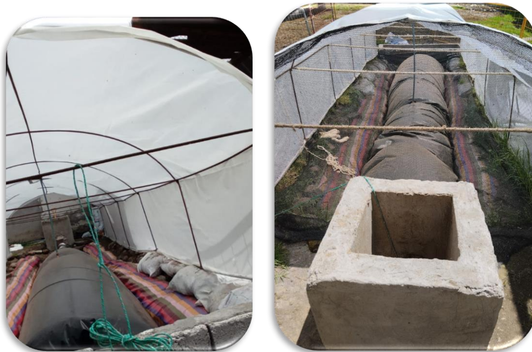
Ilustración 22-3: De izquierda a derecha, toma de salida y toma de entrada del biodigestor.
