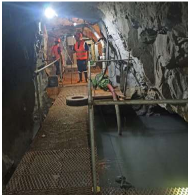
Ilustración 20-4: Medición de la Estación de Bombeo Nivel 4
