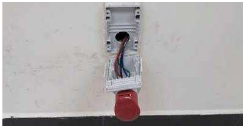
Ilustración 4-3: Cableado inicial del Laboratorio de Electricidad.
