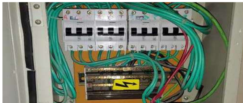
Ilustración 6-3: Sub-tablero inicial del Laboratorio de Electricidad.
