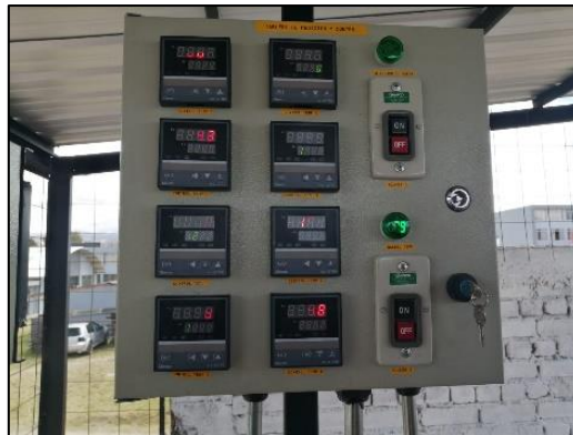
Figura 13-4: Control de temperatura-Tablero de instrumentación
