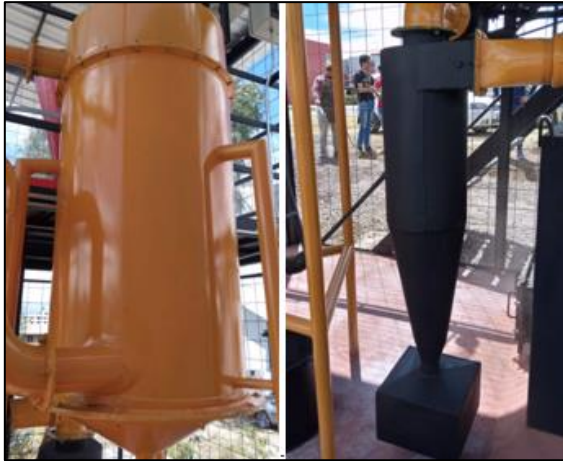
Figura 16-4: Filtrado del syngas
