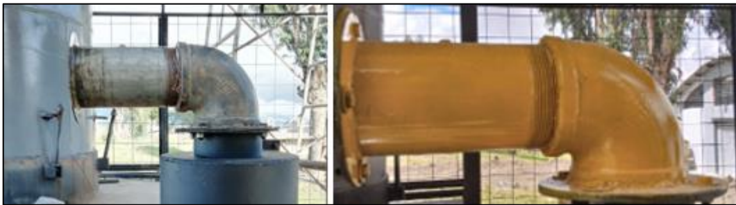
Figura 2-4: Habilitación de la línea de conducción de ciclónico a intercambiador de calor
