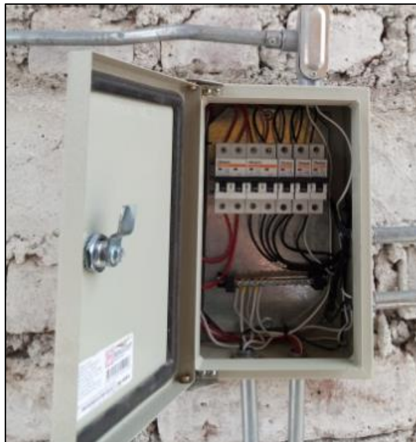
Figura 11-4: Tablero de distribución
