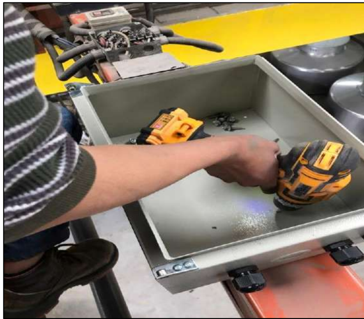
Ilustración 58-3: Anclaje del tablero eléctrico al puente grúa
