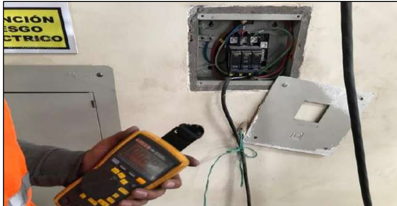
Ilustración 56-3: Revisión del voltaje de alimentación al puente grúa
