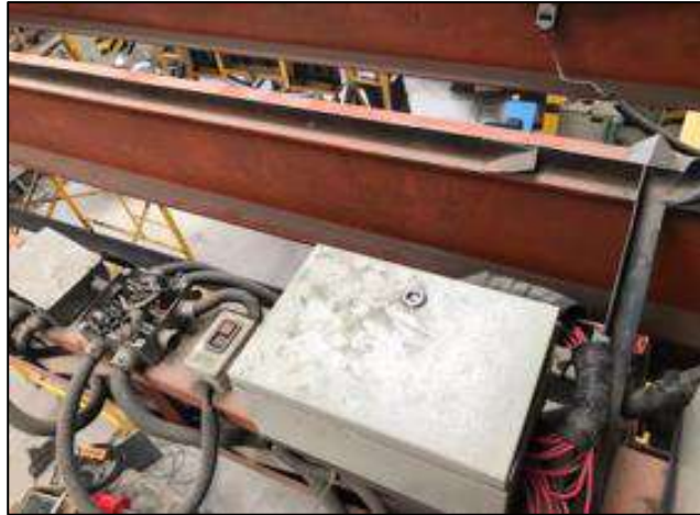
Ilustración 20-3: Acometida eléctrica del puente grúa
