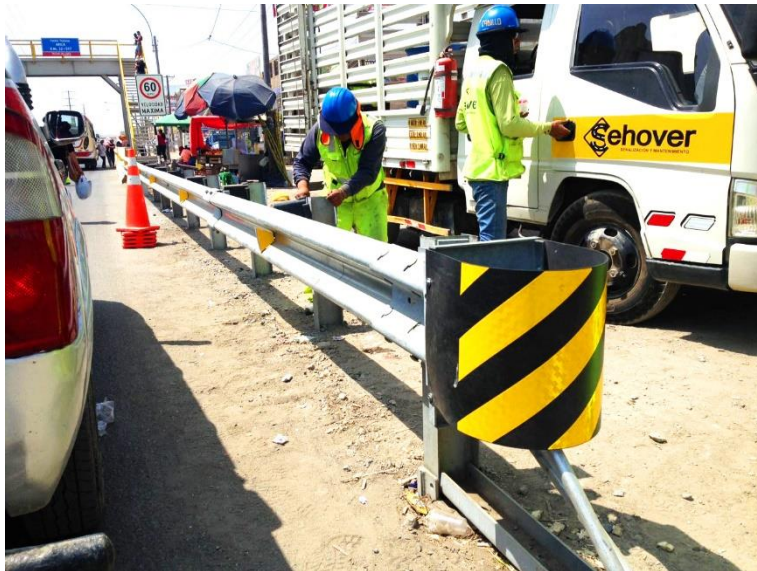
Figura 7-1. Barrera de contención con amortiguador de impacto. Fuente: (Chaverri Jimenez, 2006)
