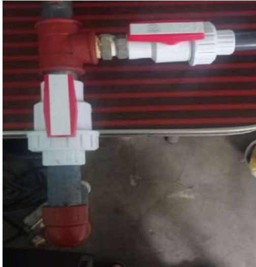
Ilustración 27-3: Válvulas de 3/4 y 1 pulgada
