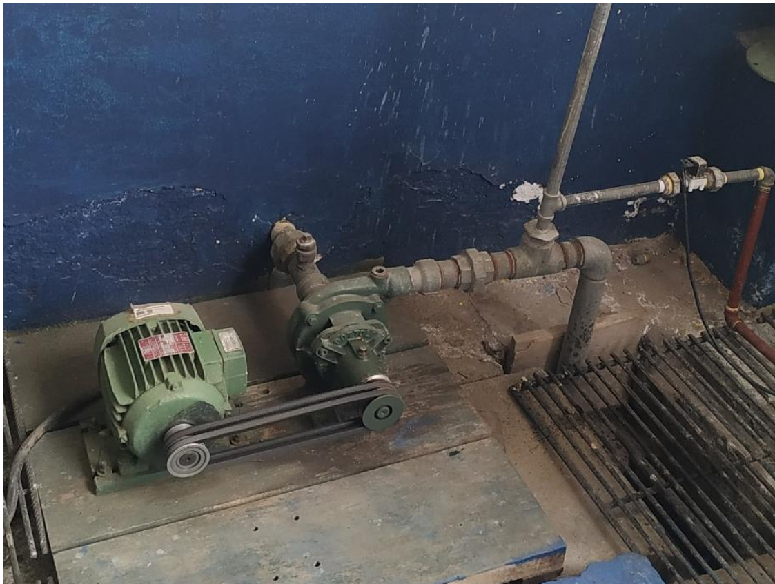
Figura 8-2. Bomba de agua y tuberías del sistema de refrigeración del banco dinamométrico
