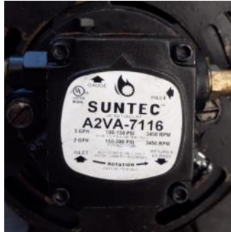
Figura 7-2: Bomba de combustible
