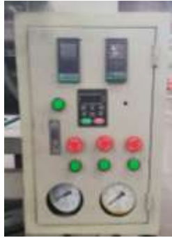
Figura 2-4: Tablero de control
