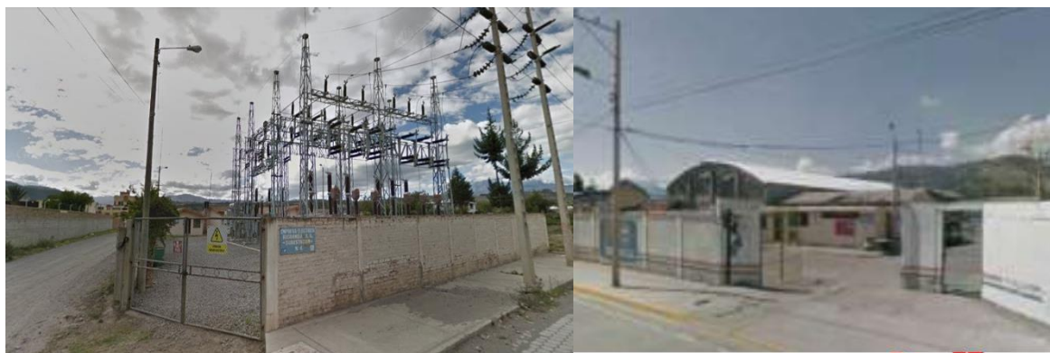
Figura 4-3: Infraestructura en el Alcance del SGC, de izq. Subestación 3 y Subestación
