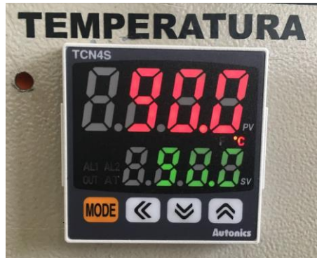
Figura 4-2: Colocación del controlador PID TCN45
