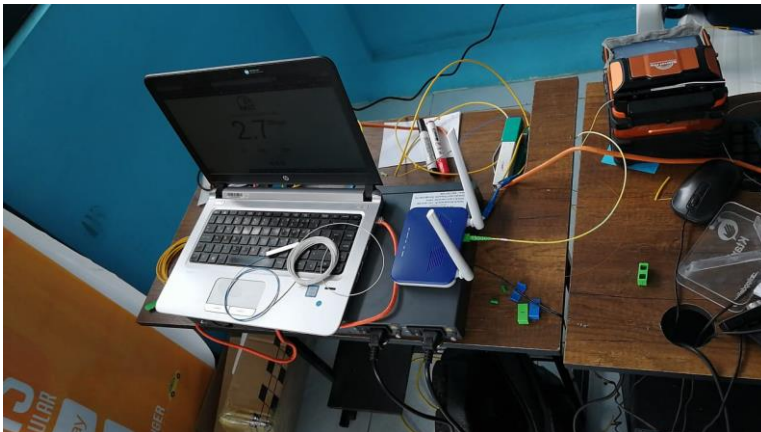
Revisión de equipos
