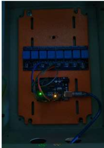
Figura 46-3. Tablero eléctrico – circuito de control.
