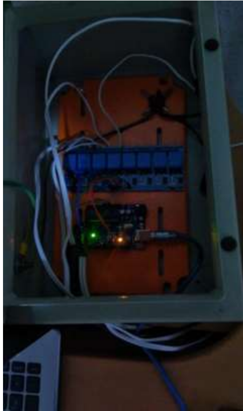
Figura 47-3. Tablero eléctrico – circuito con cargas.
