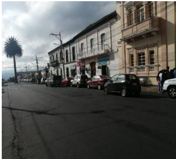
Figura 6-3: Fisuras en la calzada vial.
