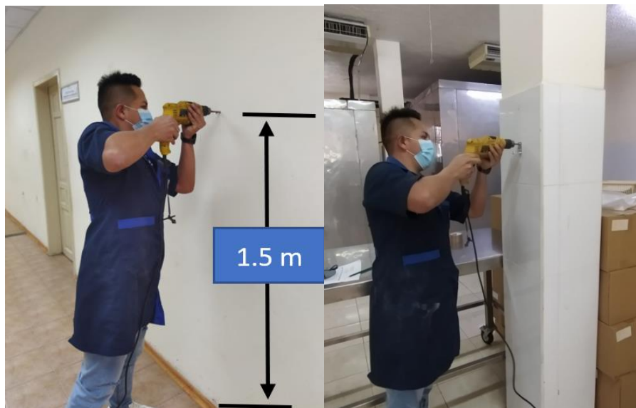
Figura 3-4. Implementación de extintores portátiles
